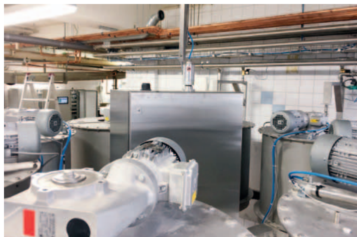
Anybus Wireless Bolt è montato sulla parte superiore della macchina da forno e comunica via Bluetooth con un altro Anybus Wireless Bolt posizionato sulla parte superiore del quadro di controllo
