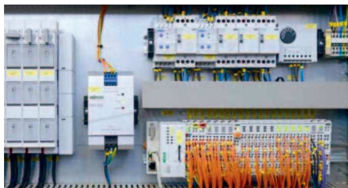
Foto fonte Voestalpine
