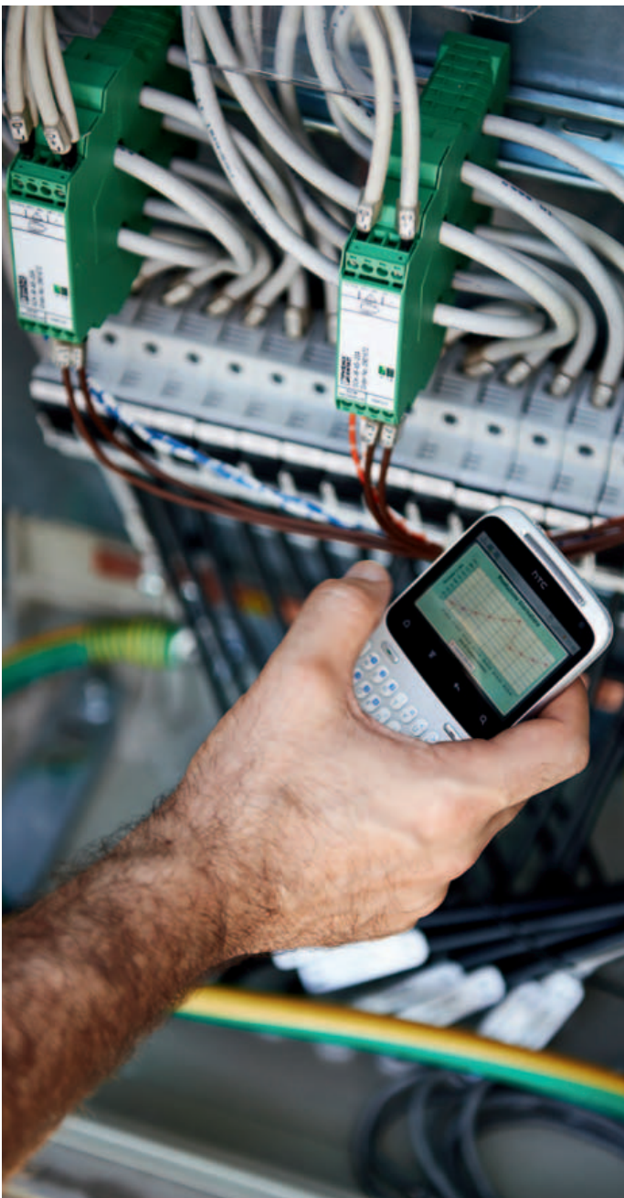
Le informazioni vengono acquisite via TCP/IP in modo da essere fruibili via Internet utilizzando un browser standard
