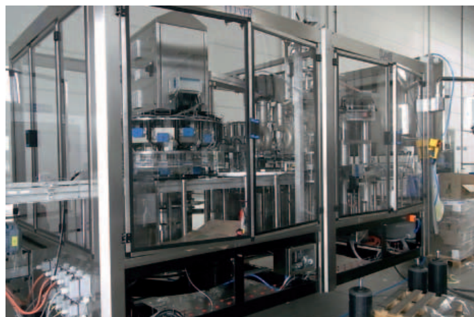
I cavi radianti di ProSoft Technology sono risultati essere una valida alternativa ai costosi cavi striscianti prima in uso
