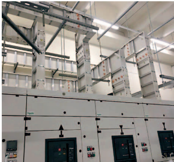
Schneider Electric ha fornito, fra l'altro, il quadro di media tensione connesso SM6 e i quadri generali in bassa tensione per il controllo e comando motore
