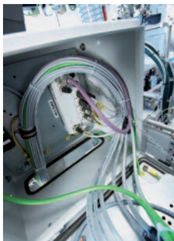
I sensori fotoelettrici di Sick sono collegati tramite un modulo IO-Link Profibus e, supportati dai blocchi funzionali Sick, sono integrati nel sistema di controllo Elau
