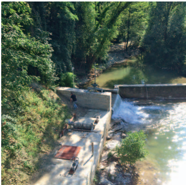
Il sistema di trasmissione dati via satellite implementato permette la comunicazione dati dai dispositivi installati alla centrale operativa
